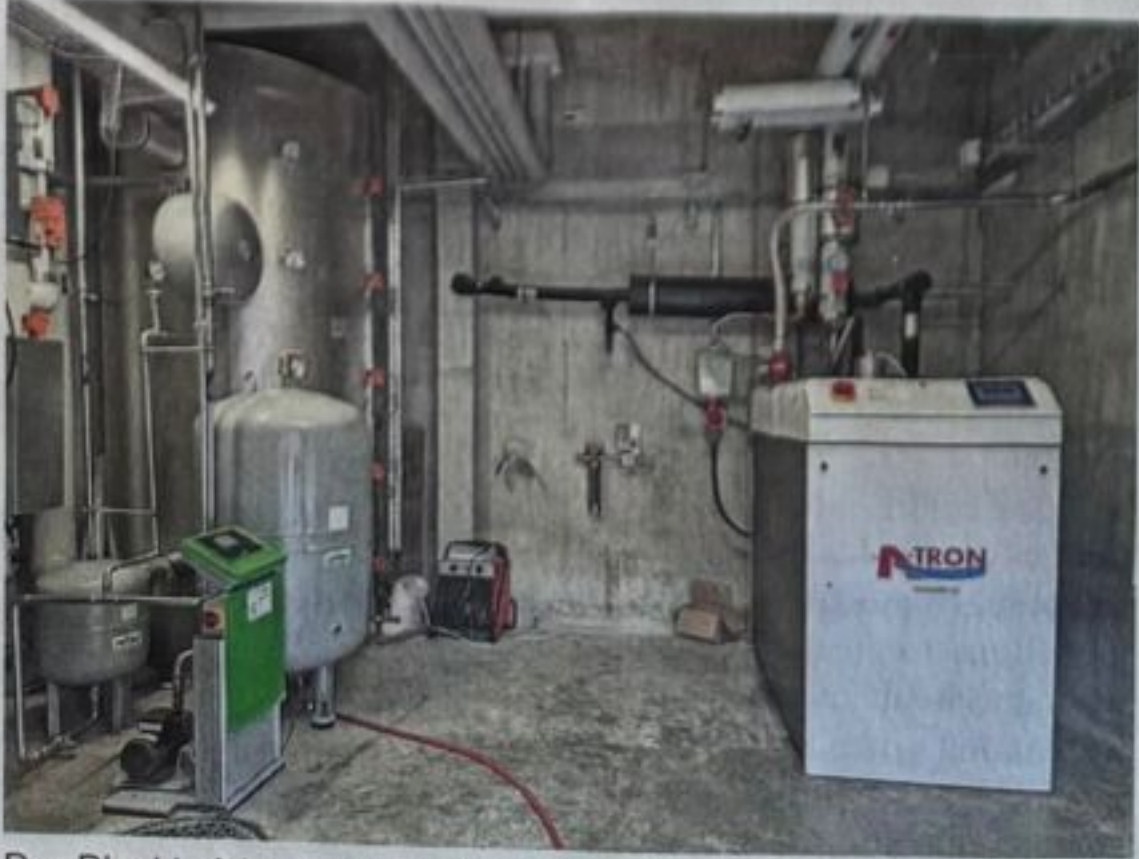
Das Blockheizkraftwerk ist im Erdgeschoss des verlängerten Heulagers installiert.
